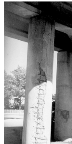
(d) Column Corrosion
