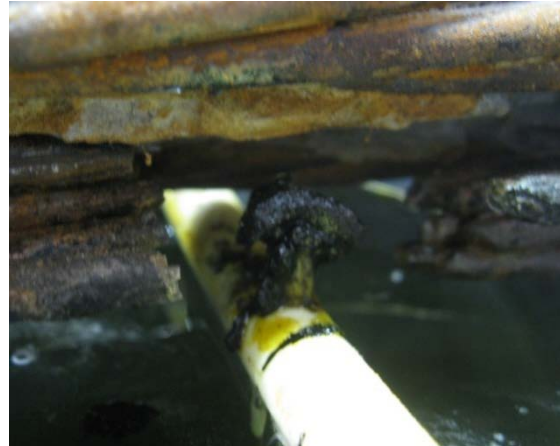
(d) Complete Strand Fracture
