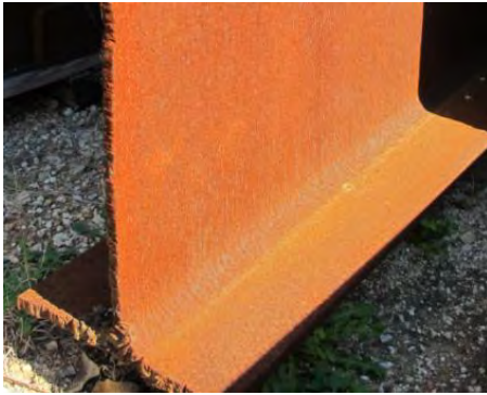
a) W30x99 rust surface
