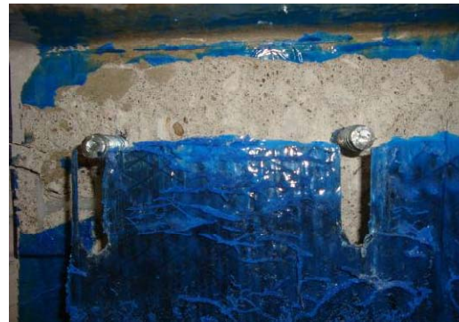
(d) Slippage of discontinuous CFRP plate
