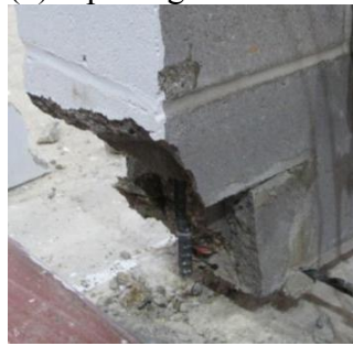
(d) Fracture at south end
