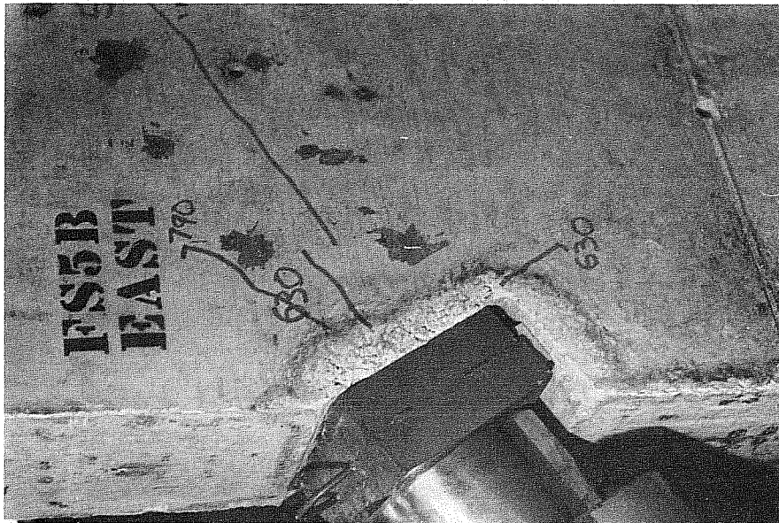
(d) Diagonal cracking, east side
