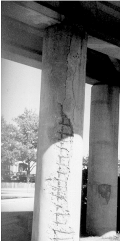
(d) Column Corrosion
